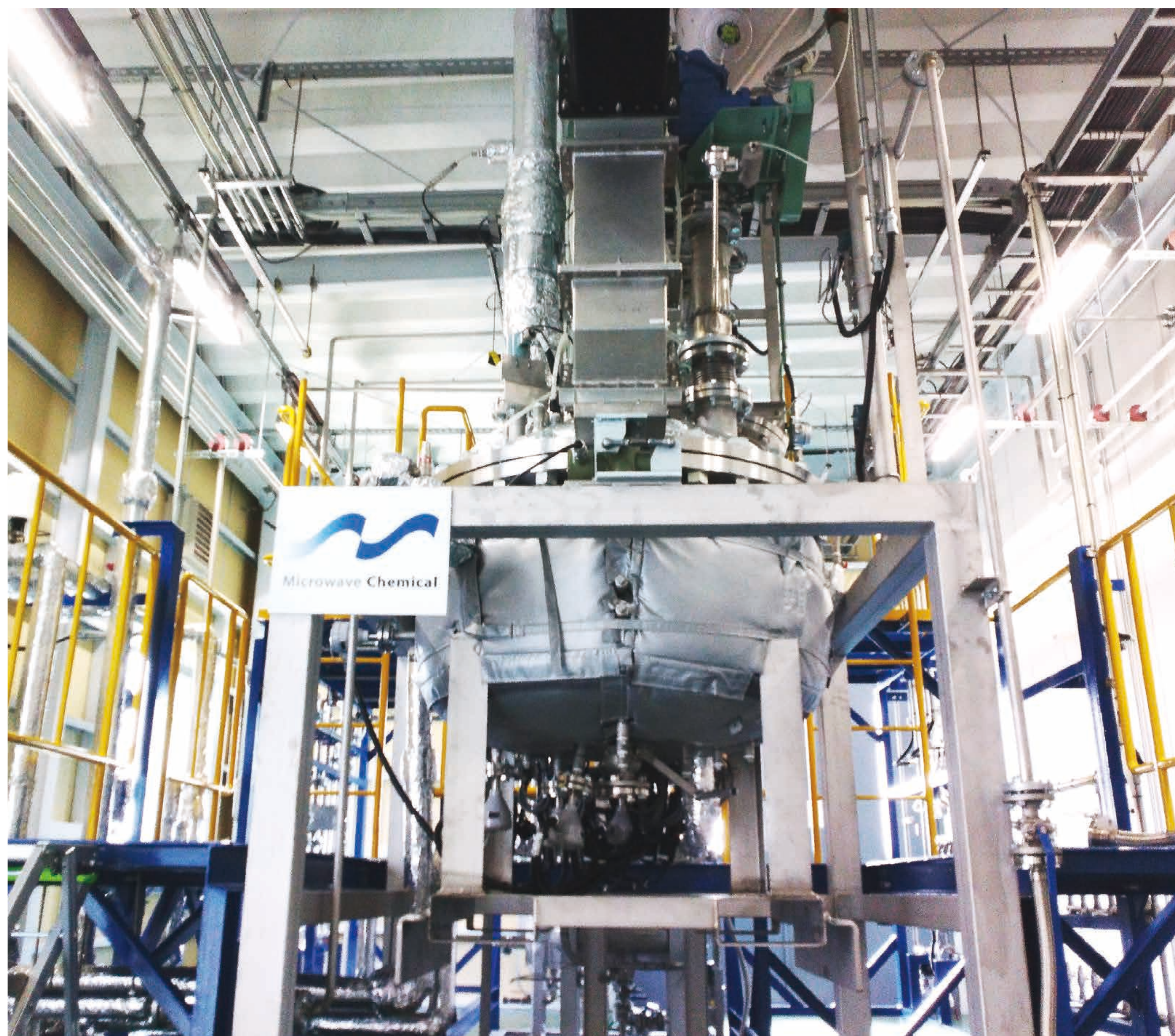
1日当たり1tの処理能力を持つ大型汎用実証設備
