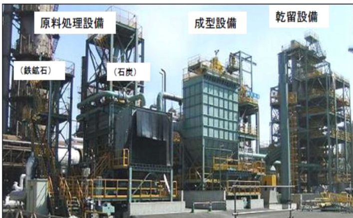
30t/dパイロットプラント全景
