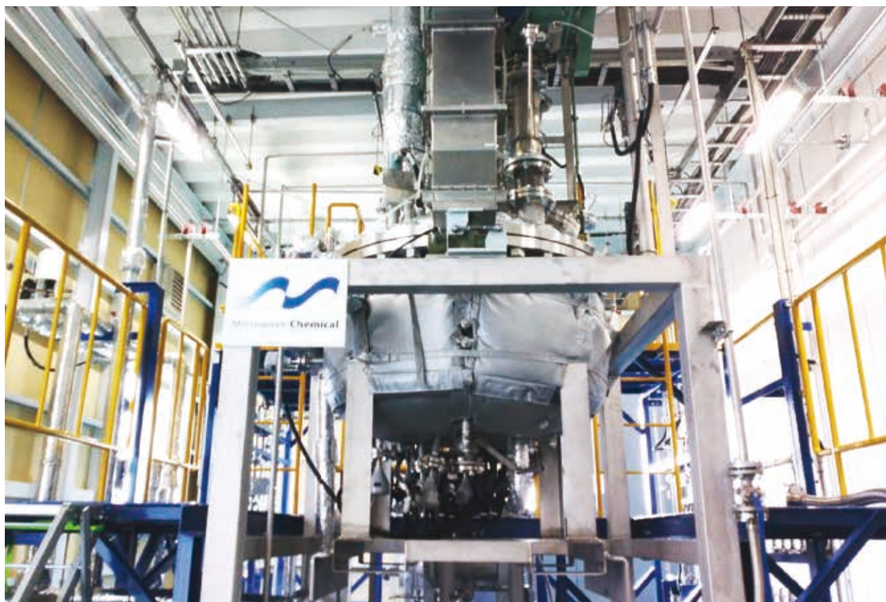
1日当たり1tの処理能力を持つ大型汎用実証設備
