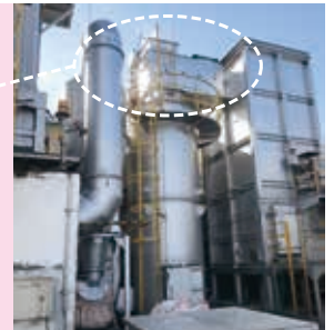
廃熱の採取場所 実験時の採熱温度:50～60℃ 実発電電力:1～1.5kW
