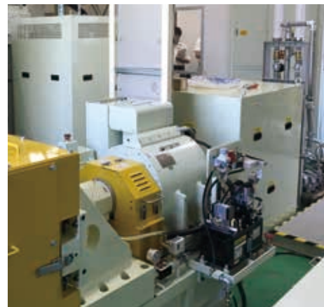
図2 導入試験設備
