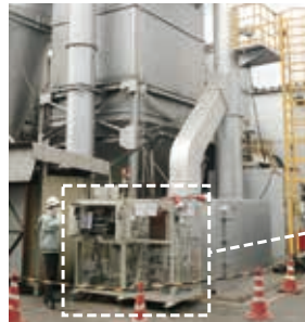
実証実験機設置状況 ORC発電システムサイズ(本体) 幅1.8m × 奥行1.3m × 高さ1.6m
