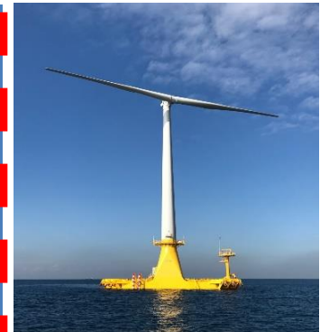
NEDO北九州沖 3.0MW 実証研究中
