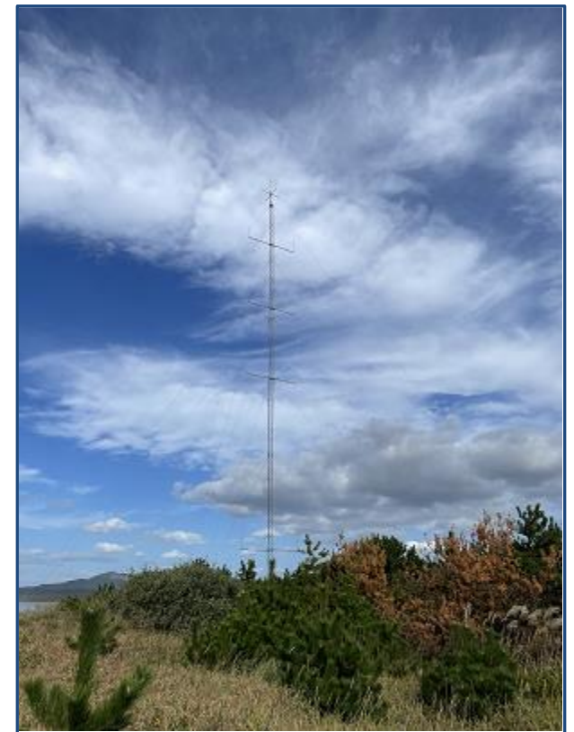
図 気象観測マスの設置状況
