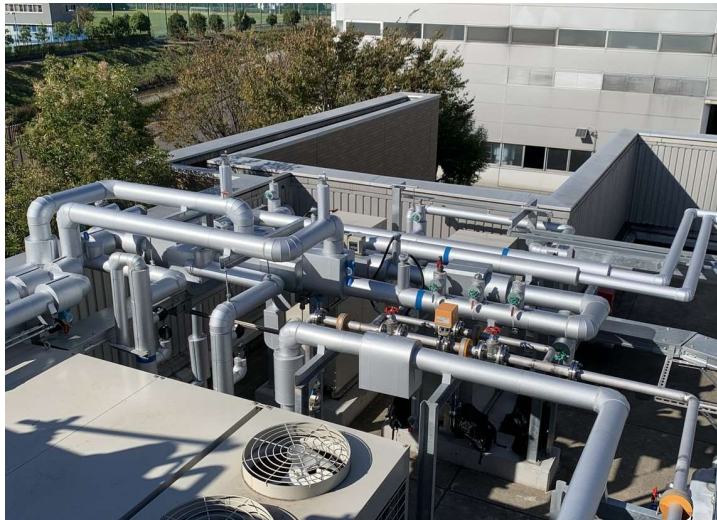
熱源水ループ配管
