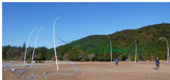
図 1-5-2-1-d-2-1.2 固定翼機受け止め装置の設置風景
