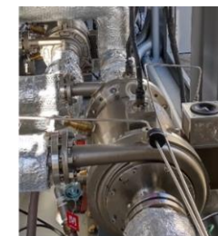
ユニット内部
