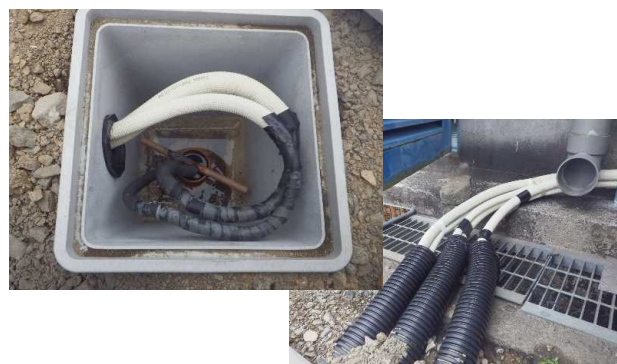
直接膨張方式地中熱交換器
