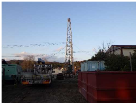
図 4.3.1-3 大口径水井戸に対応する熱応答試験装置
