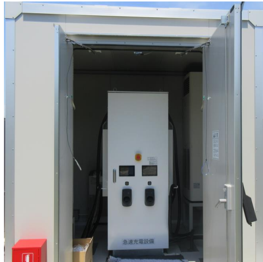
急速充電器 (盤収容)
