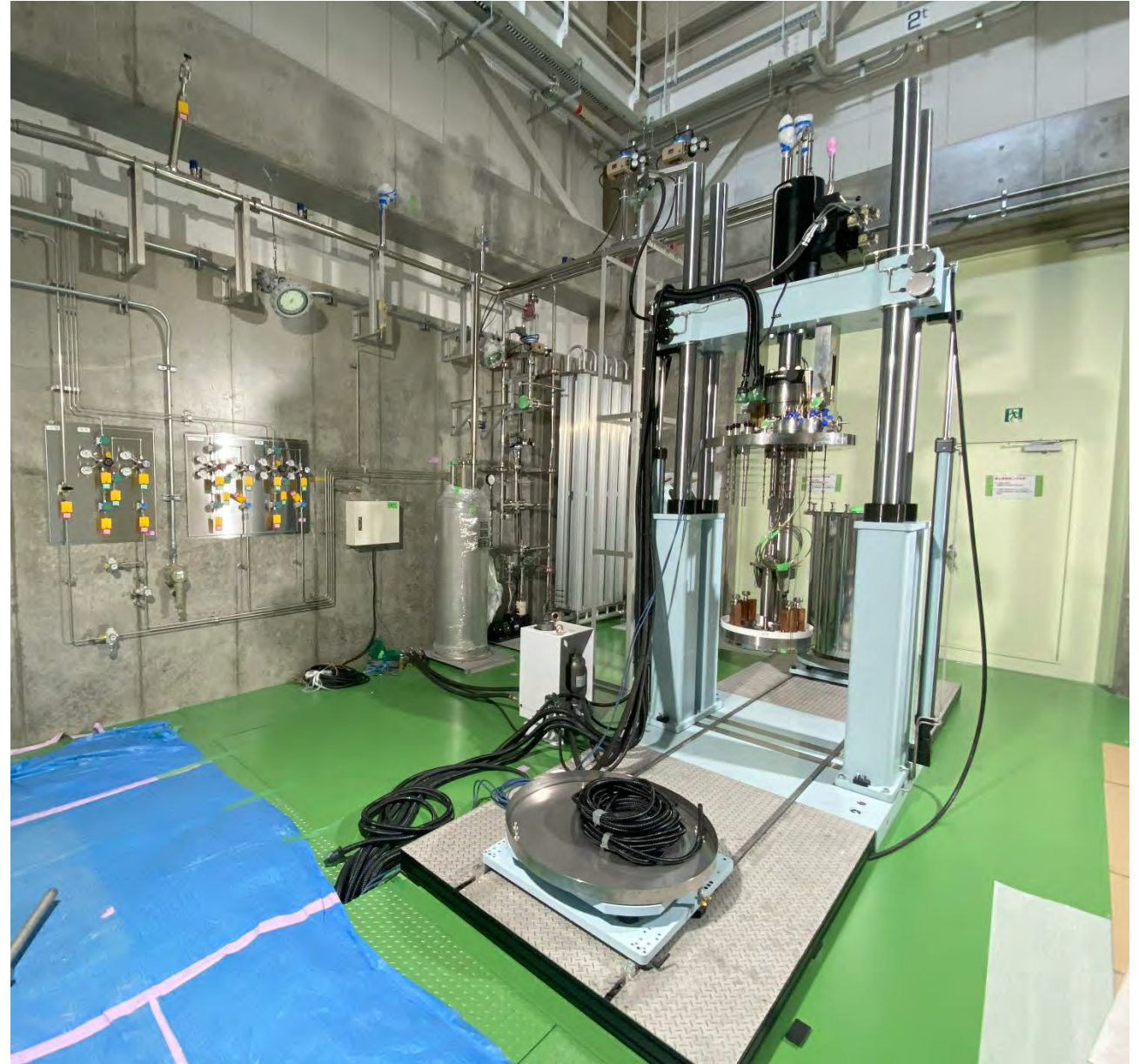
評価試験設備（据付調整中）
