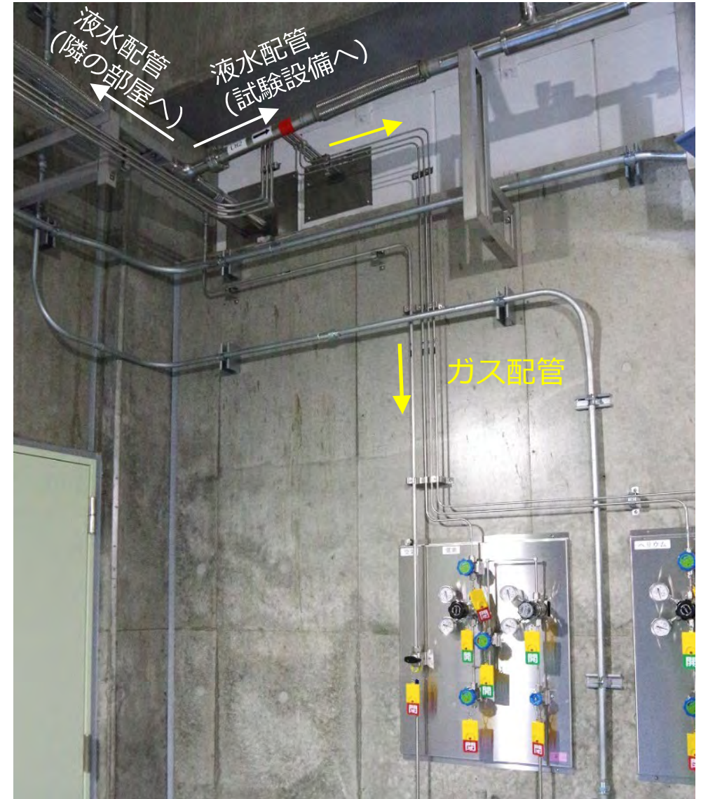
特殊ガス配管、液化水素配管
