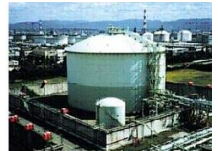
防液堤と大型平底円筒形貯槽 3 の例（LNG貯槽）
