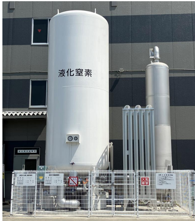
液化窒素試験設備
