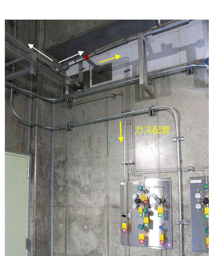
特殊ガス配管（液化水素供給系）
