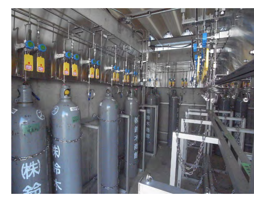
特殊ガス配管（高純度ガス供給系）
