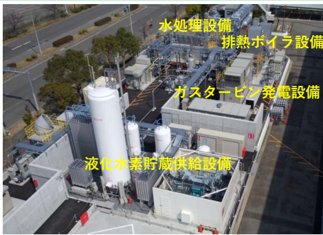
「水素CGS実証プラント」設備概要
