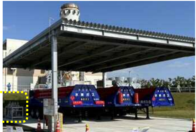
新設：水素ガス供給設備外観 ↳ 圧縮水素ガストレーラー接続中
