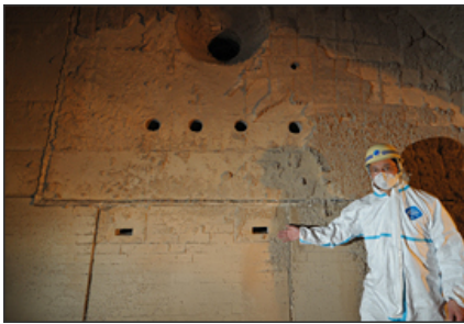
炉の内壁。 指をさしているのが、高温空気が出てくる孔。
