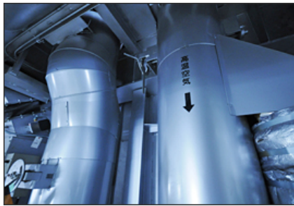
高温空気が送られるパイプ。
