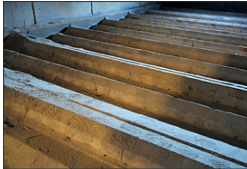
ストーカ炉の内部。 ストーカ（火格子）が階段状になっている。
