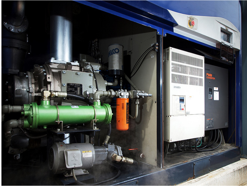
スチームスター内部。左側の上部からパイプがつながった部分がスクリュー格納部。 右側は、インバータや制御機器
