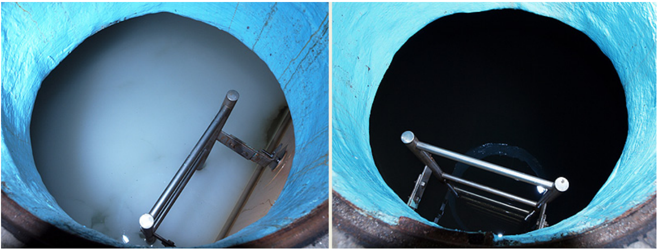
川崎駅地下街の駐車場の下に置かれている連結混合型蓄熱槽。 左が冷熱を蓄えて白色の水和物スラリー、右が熱を放出して透明になった水溶液
