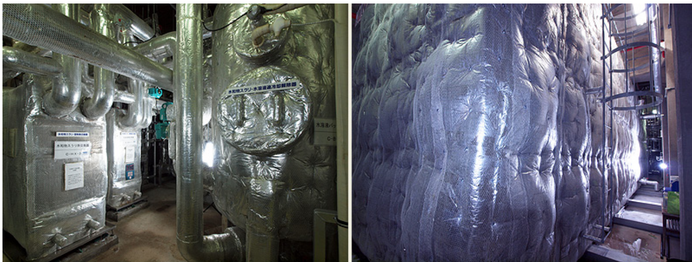
JFE エンジニアリング本社1号館の地下にある水和物スラリの製造システム (左) 容量 350 m 3 の蓄熱槽 (右)
