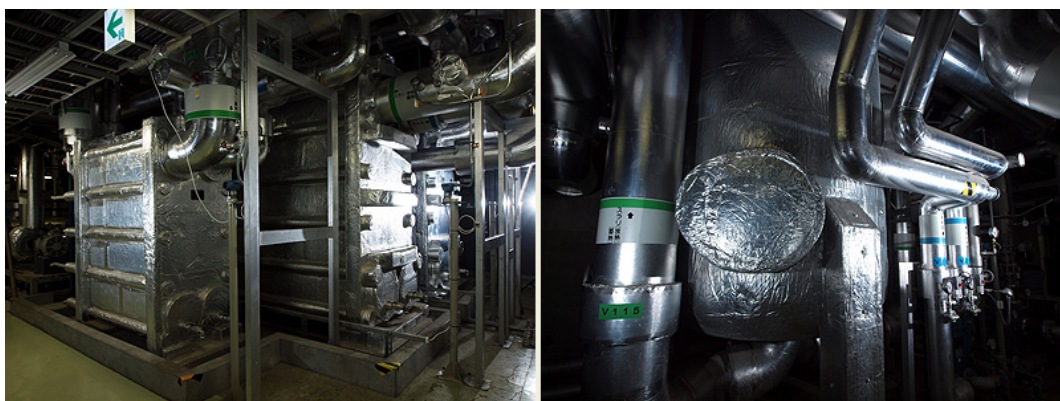
川崎駅地下街「アゼリア」の空調システムに取り付けられた水和物スラリの製造装置。水溶液過冷却器とネオホワイト冷却器(左写真)、過冷却解除器(右写真)
