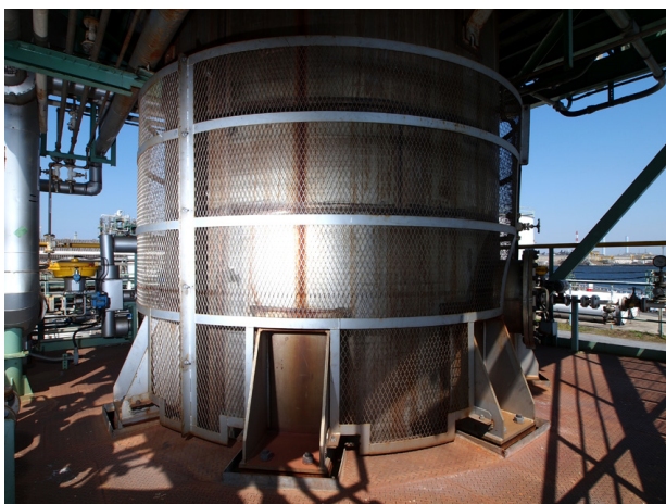
ハステロイ（ネットの内側）で覆われた燃焼炉
