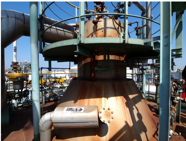
燃焼炉上部のバーナー部分
