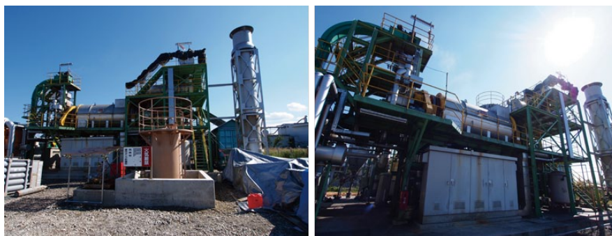
横手市で実証試験中のバイオマスガス化トリジェネレーション発電システムの全景
