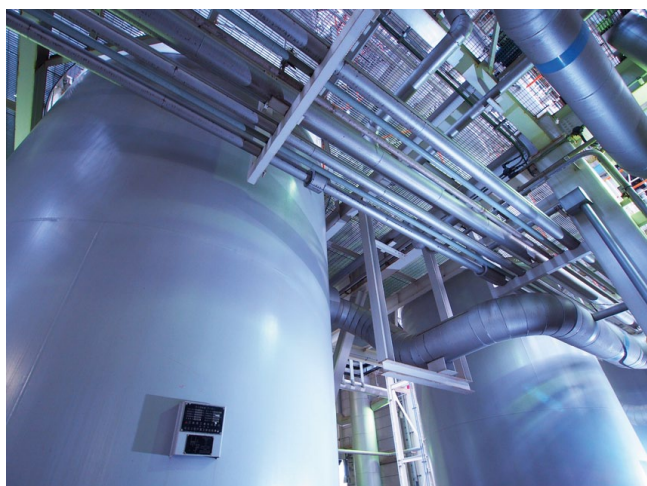
ガス精製設備、写真は冷却洗浄塔
