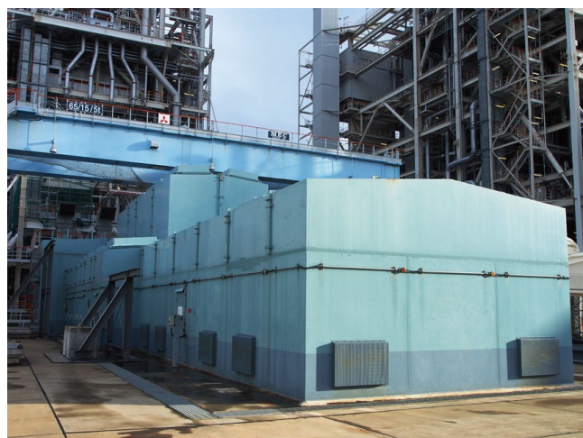
高効率ガスタービンコンバインドサイクル
