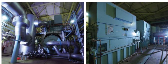
ガス化炉に空気を送り込む配管（左）、空気圧縮機（右）
