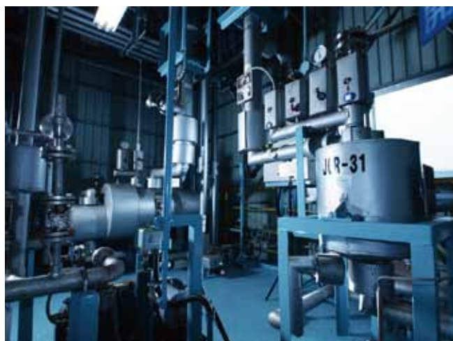
実証プラントの第 1 蒸留塔（右）と精製塔（左）
