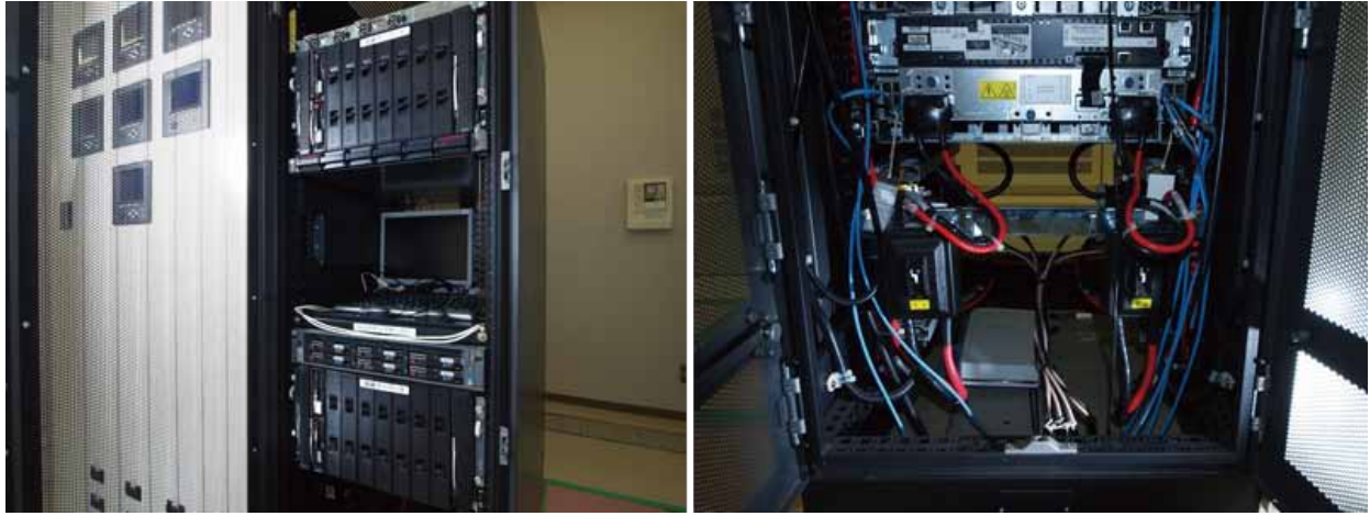
実証プラントコントロールルーム内で稼働する直流電源用サーバ（実証時のインテル製とは異なります）
