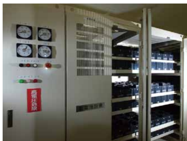
実証プラント内に設置された太陽電池（直流） 連携コンバータ（左側）と蓄電池（右側・直流）
