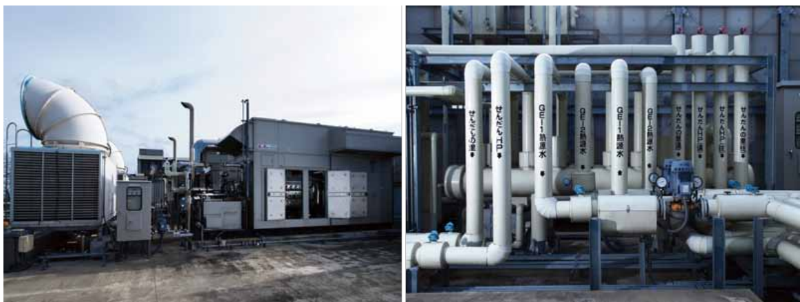
実証プラントのガスエンジン発電機（左）を利用したコ・ジェネレーションシステム、電力と温水（右）を実証研究エリアの施設に送る
