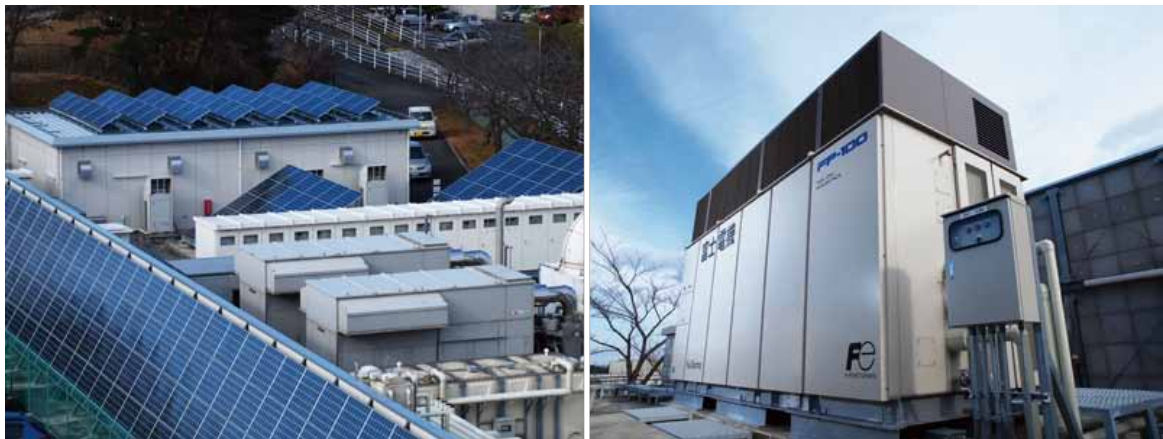
プラントに設置された太陽電池（左）と、燃料電池（右・実証試験後更新されたもの）
