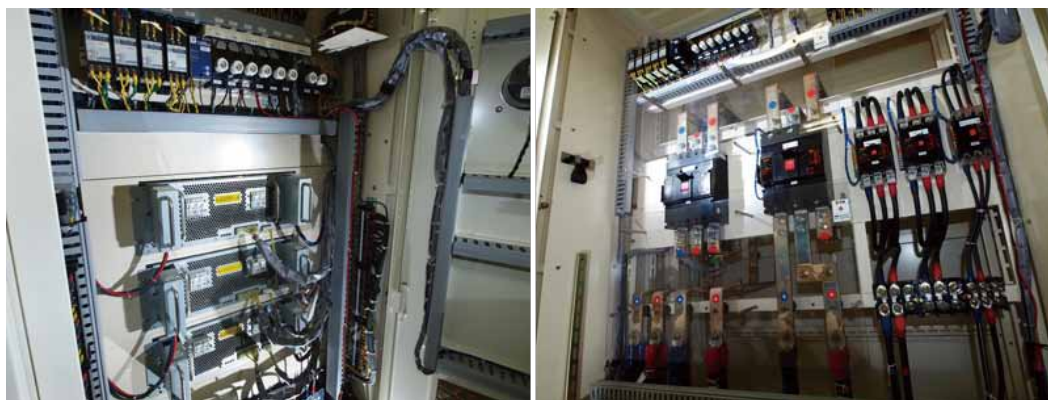
実証プラントの DC (直流) /DC コンバータ (左) と、直流分電盤 (右)
