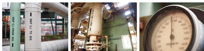
(左)富士石油と住友化学を結ぶ配管 (中央)富士石油プラント内の熱交換器 (右)住友化学から受け取った排水熱の温度ゲージ
