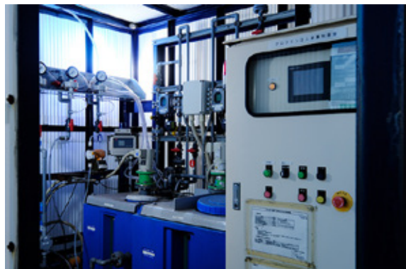
写真 6 施設内のクロラミンの合成施設。分解しやすいため次亜塩素酸ナトリウムとアンモニアを施設内で混ぜてつくる
