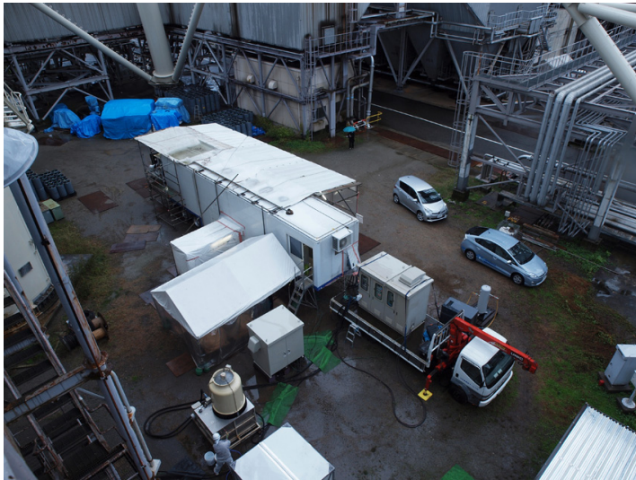
富山新港火力発電所内に設置されたトレーラー。 前部のトラックには誘導加熱溶融炉の電力を 制御するインバータが搭載されている
