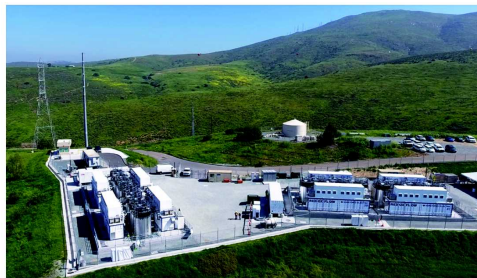
図1 米国カリフォルニア州に設置したRF電池によるシステム
