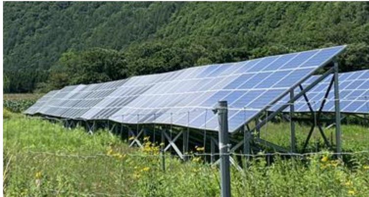
写真 1-1 太陽光発電設備の架台の凍上被害の一例
