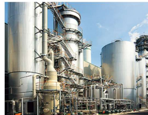
オゾン漂泊設備
