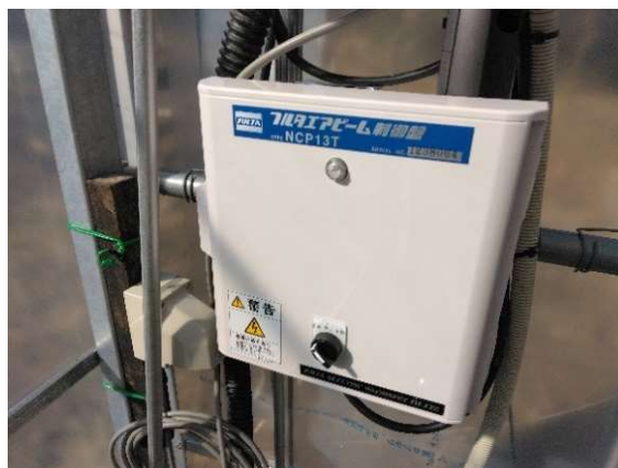
散水設備（制御盤）
