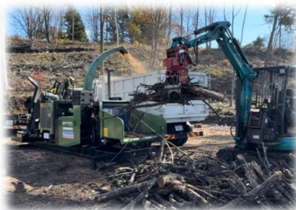
現地破碎状況
