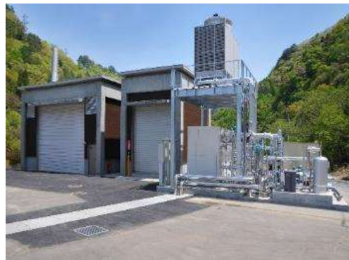
上野村木質バイオマス 発電施設
