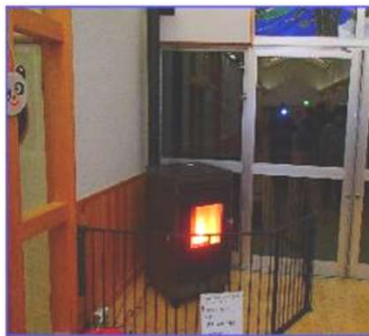
村営住宅ペレットストーブ
