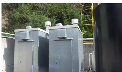
気化熱源用ボイラ
