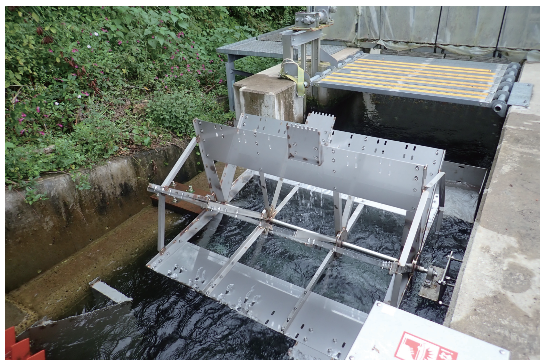
無電力式除塵機 出典：(株)荒谷建設コンサルタント
