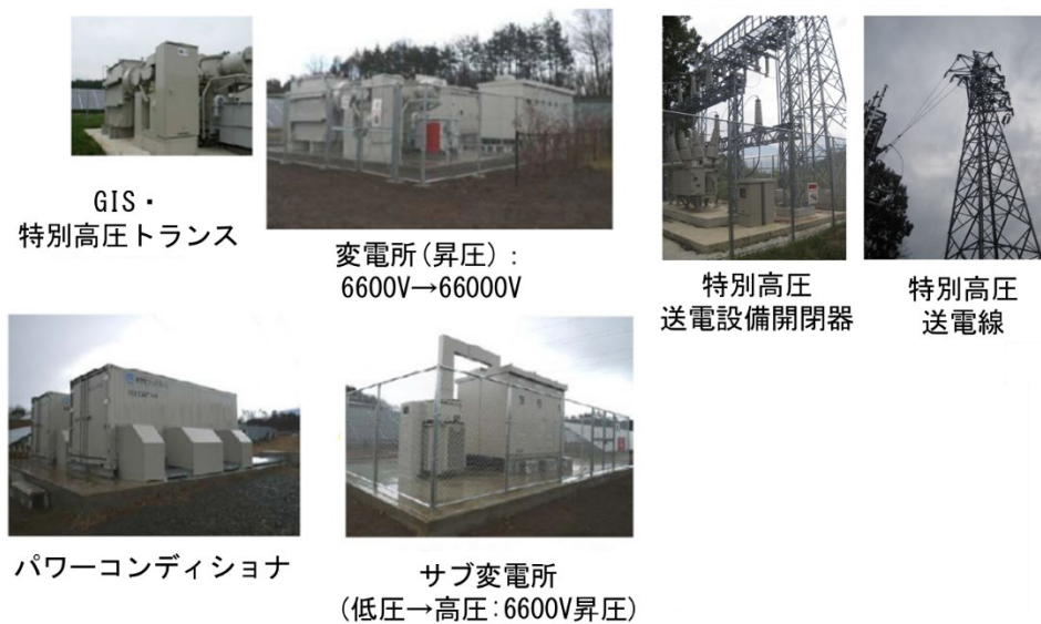
図 13-14 特別高圧設備の受変電設備の例
