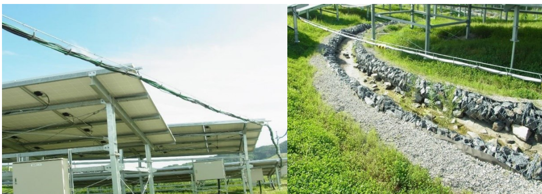
写真 14-2 架空配線の例
