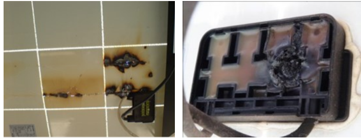
図 13-2 太陽電池モジュールからの異常発熱・発火事例
