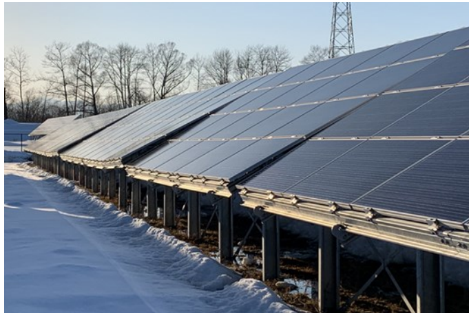
図 5-17 太陽光発電設備の凍上被害の一例
