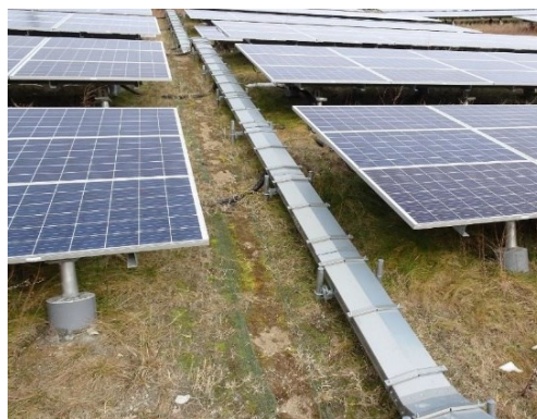
写真 14-1 ラックによる地上配線の例
