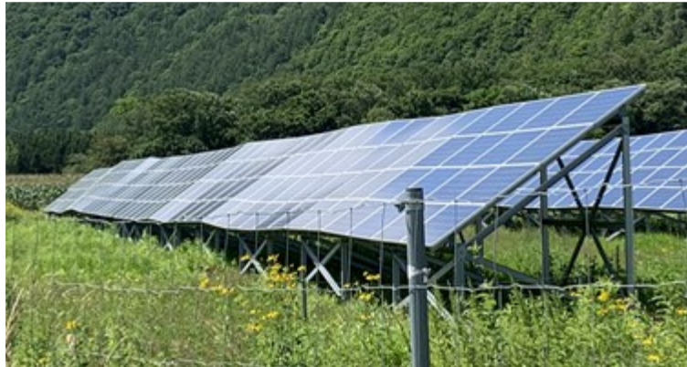
写真 1-1 ソーラーパネル架台の凍上被害の一例
