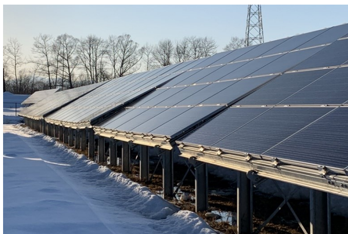
図 1-1 太陽電池アレイ架台の凍上被害の一例
