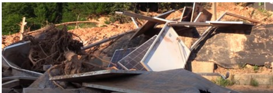
写真 2-1 傾斜地設置型太陽光発電設備の豪雨被害事例（1）写真提供：PVeye
