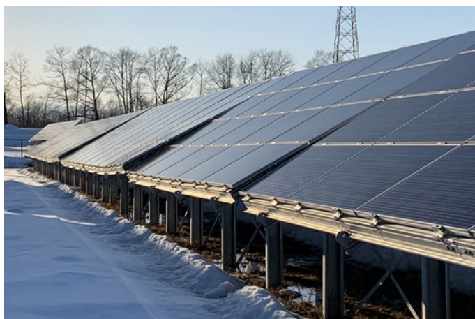
図 5-8 太陽光発電設備の凍上被害の一例
