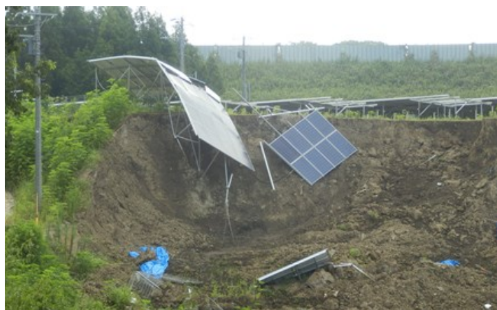
写真 2-4 傾斜地設置型太陽光発電設備の豪雨被害事例（4）写真提供：一般市民
