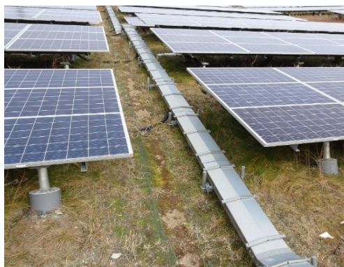
写真 13-1 ラックによる配線の例
