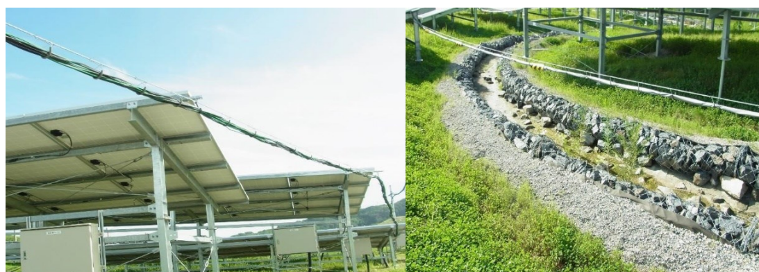
写真 13-2 架空配線の例
