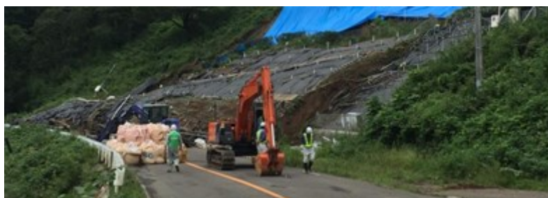
写真 2-3 傾斜地設置型太陽光発電設備の豪雨被害事例（3）
