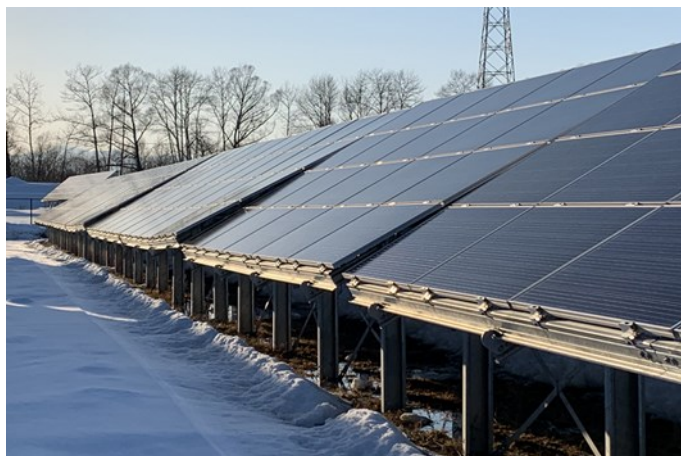
図 5-10 太陽光発電設備の凍上被害の一例
