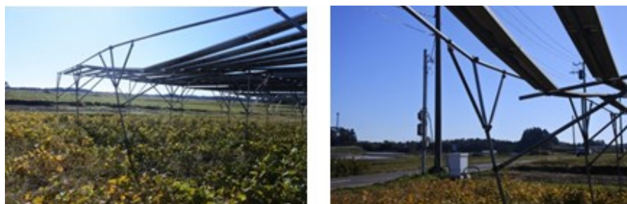
写真 2-2 営農型太陽光発電設備の強風被害事例（2）
