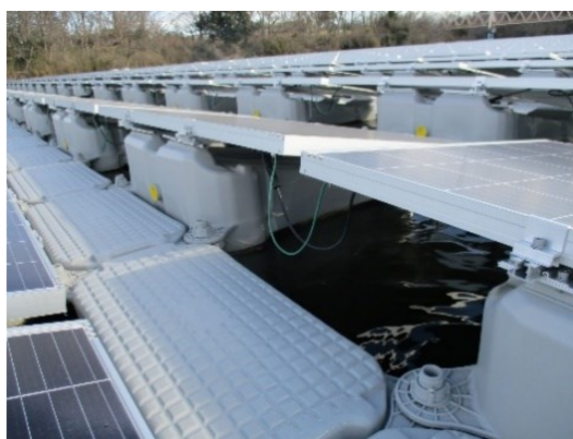
写真 12-1 余長を考慮した配線の例
