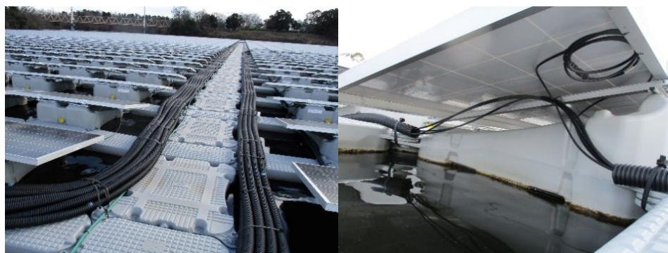
写真 12-2 配管に納めた配線の例
