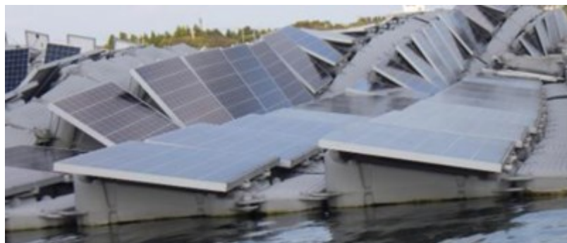
写真 2-3 水上設置型太陽光発電設備の強風被害事例 (3)
