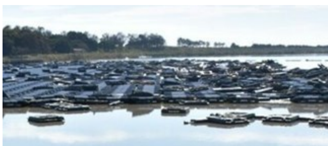
写真 2-1 水上設置型太陽光発電設備の強風被害事例（1）
