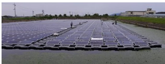
写真 2-2 水上設置型太陽光発電設備の強風被害事例（2）
