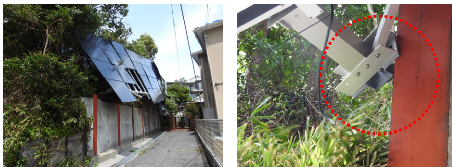
写真 2-1 陸屋根に設置された太陽光発電設備の強風被害事例
