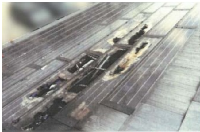
写真 2-5 住宅に設置された太陽光発電設備の火災事例
