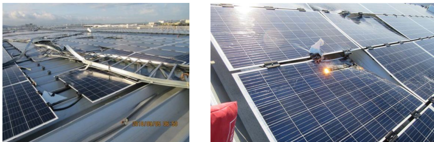
写真 2-2 折板屋根に設置された太陽光発電設備の強風被害事例
