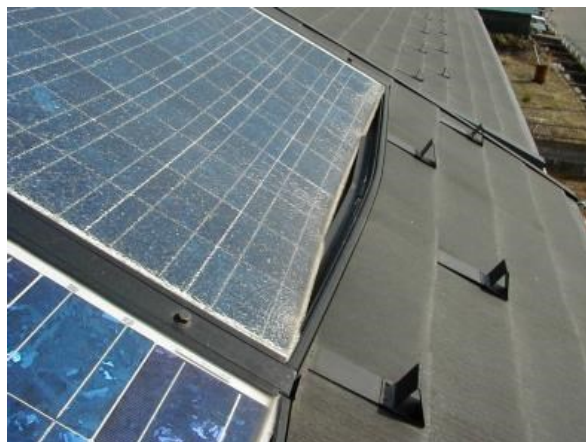
写真 2-3 住宅に設置された太陽光発電設備の地震被害事例 (出典：有限会社吉富電気提供)
