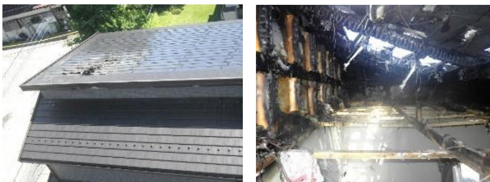
写真 2-6 住宅に設置された太陽光発電設備の火災事例
