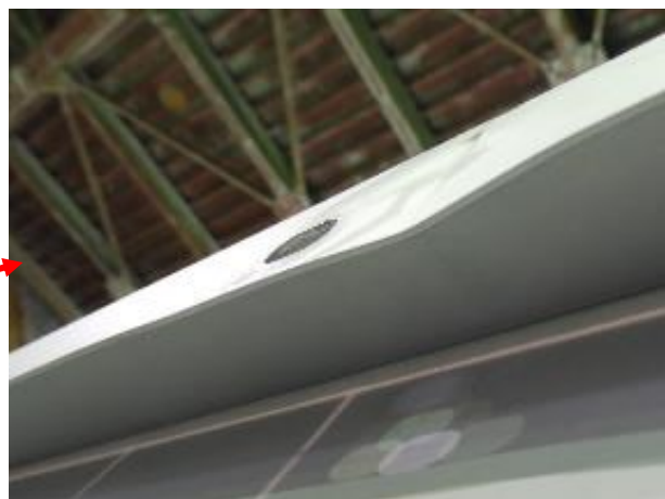
写真 5.2.6 アルミフレーム変形位置拡大
