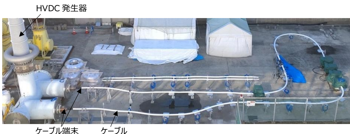
図 4-3-12 電気試験線路
