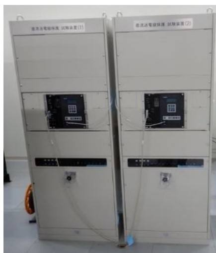
図 4-1-12 保護検出装置（日立製作所製、1 回線分×2 台）
