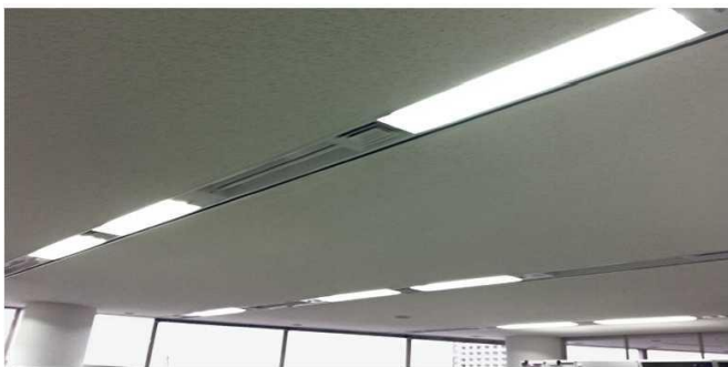
照明(LED)の間引き消灯を実施
