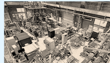
連続試験モデルプラントの整備
