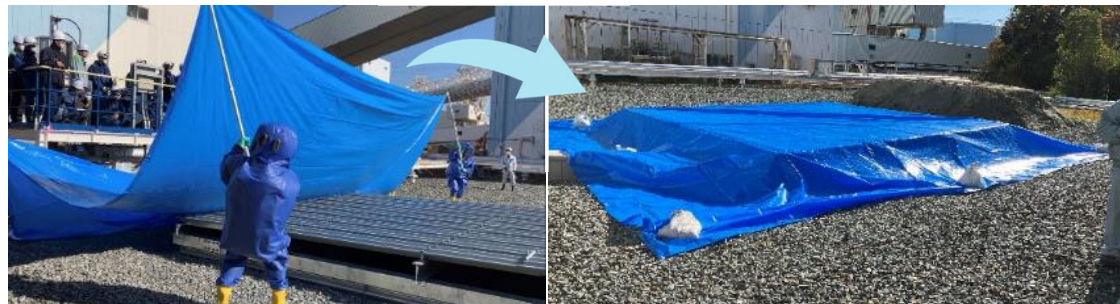
③ タープ&カバーによる溜め升内の低温液氨の蒸発拡散抑制
