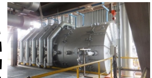
IHI燃焼試験設備
