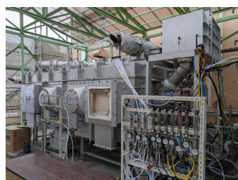
＜アンモニアベンチスケール炉＞
