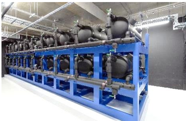
吸蔵合金タンク (2000kWh)
