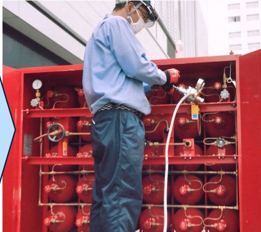
減圧弁・配管接続
